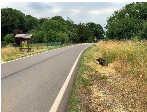
Entwässerungsobjekt an der L172 oberhalb der Straße Im Breitfeld
