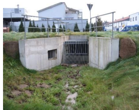
Beispiel großzügig dimensioniertes Einlaufbauwerk, Stadt Karlsruhe
