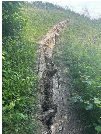
Risse im Bereich des Wanderwegs am Gauberg in Folge der Niederschlagsereignisse Pfingsten 2024, Fotos der Gemeinde
