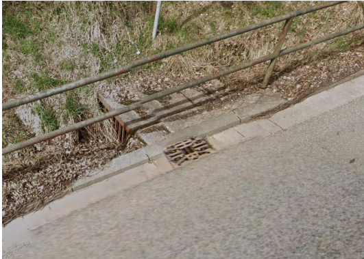
Einlauf/Graben entlang der L357, Quelle: google maps 2022
