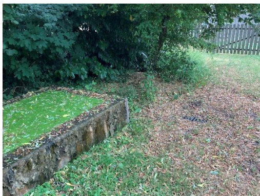
Einlauf am Dorfbrunnen, durch Laub verlegt
