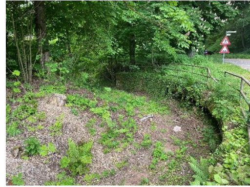
Gewässerführung im 90 ° Winkel vor dem Bahndurchlass. Ränder deutlich unterspült.
