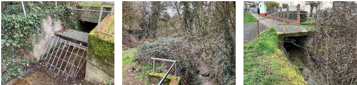
Ein- und Auslaufbereich der Verrohrung des Schoppbach
